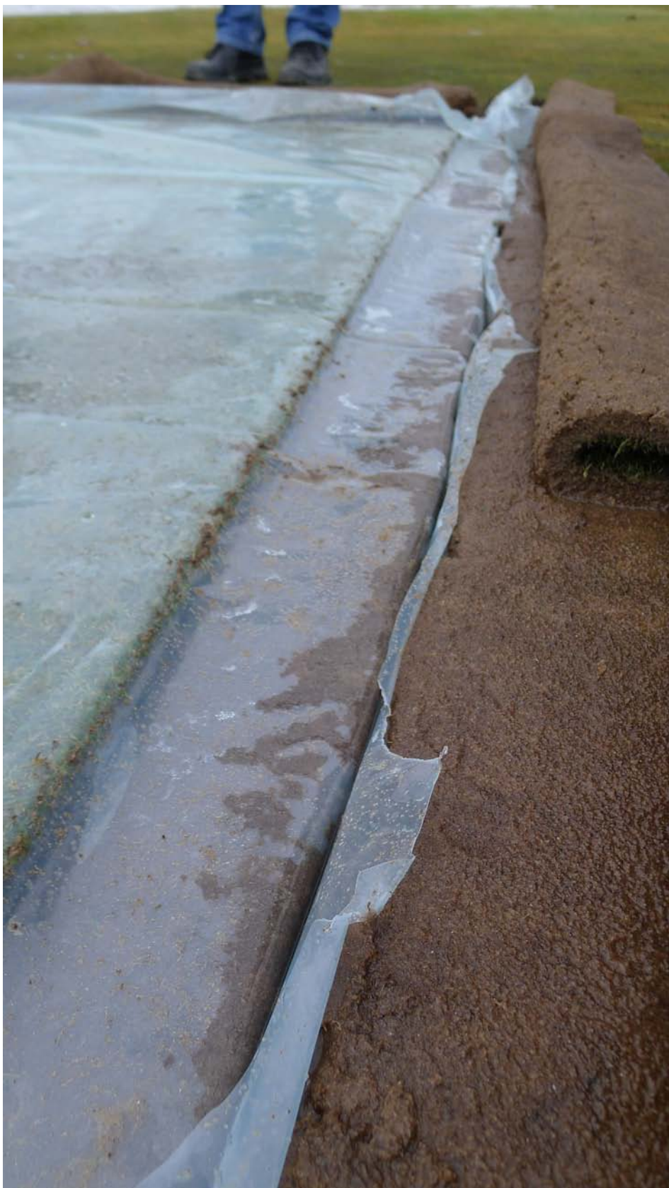
Plast er gravd ned rundt greenen og kanten forseglet med gresstorv skåret med torvkutter. Dette er nødvendig for å forhindre at vannet trenger inn under dekket. Foto: A. Kvalbein.
