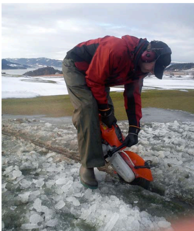
En asfalskærer kan bruges til at holde midlertidige grøfter åbne på greens. Foto: Ole Albert Kjørnes, Byneset golf.
